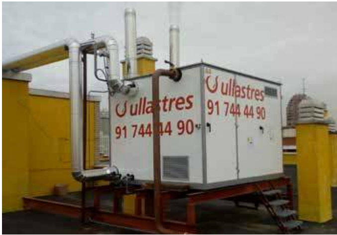
Figura 8.4 Equipo autónomo de gas ubicado en cubierta
