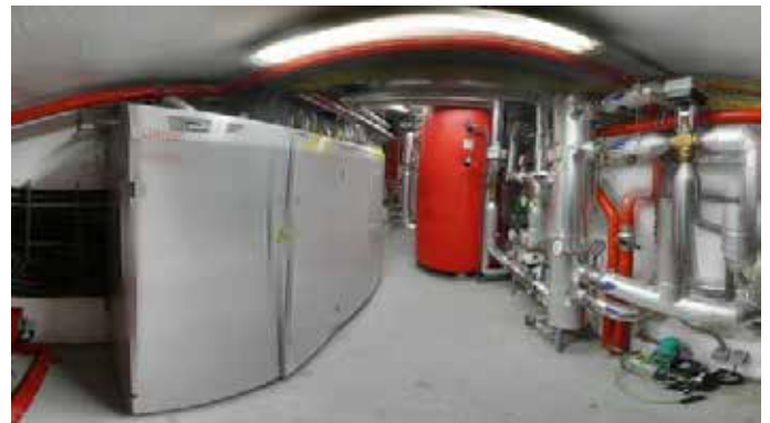
Figura 3.49 Sala técnica de una instalación centralizada de calefacción mediante geotermia y elementos radiantes. Fuente: Eneres, 2019.
