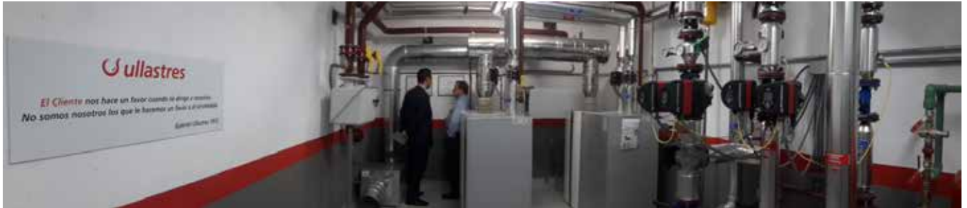
Figura 8.6 Foto panorámica de Central Térmica
