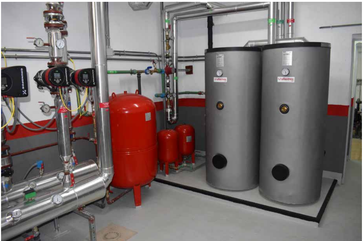
Figura 8.7 Inter-acumuladores de agua caliente sanitaria.
